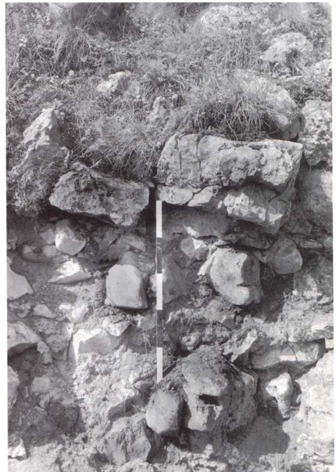
8.2 Ein häufiger Befund: Die Mauerkrone ist überwachsen, die Außenschale fehlt bereits. (Objekt: Veringenstadt, Kreis Sigmaringen, Region Bodensee — Oberschwaben.)
