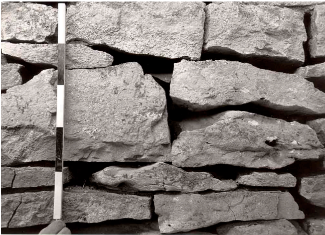
Abb. 23. Burg Brauneck, Schildmauer, Schadensbild, Mauergefüge mittelfreichendem Mörtelverlust, Zustand 1982.
